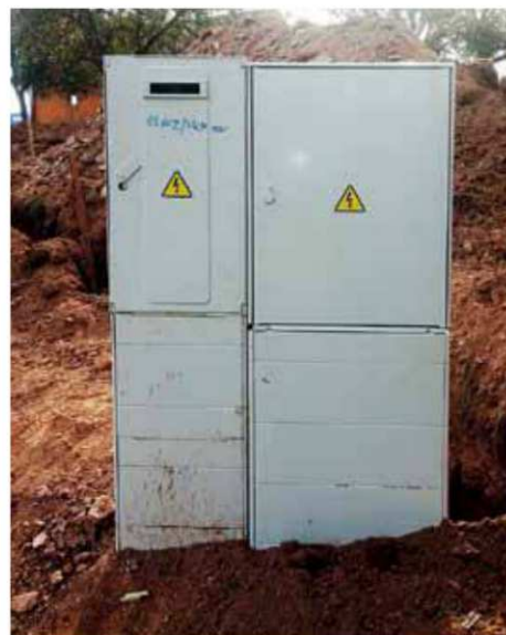
Elektroměrový rozvaděč ER je umístěn v elektroměrovém pilíři (nejčastěji na hranici pozemku) a připojuje se z pojistkové skříně poskytovatele elektřiny
